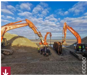
Lutte contre l'érosion entre la route blanche entre Cayeux-sur-mer et la pointe du Hourdel
